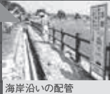
海岸沿いの配管
